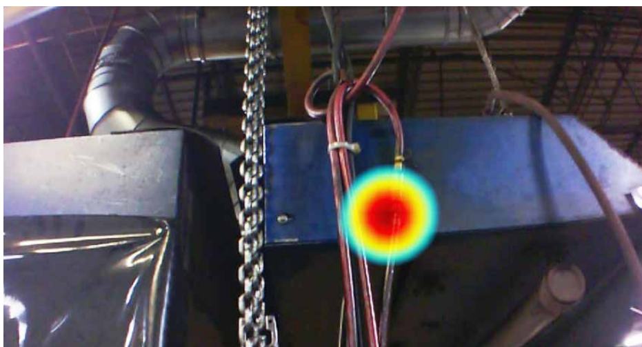
Imagem obtida com o Imageador Acústico Industrial ii900 de um vazamento de ar em um ambiente industrial.
